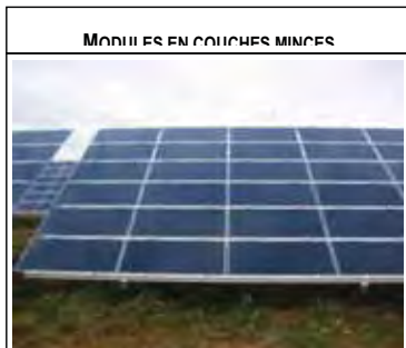
Source : Solairedirect, Bolanden, Allemagne, 2007
