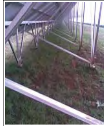
SILLONS CREUSES PAR L'ÉCOULEMENT DE L'EAU SOUS LES TABLES MODULAIRES (PARC DE VINON SUR VERDON)
